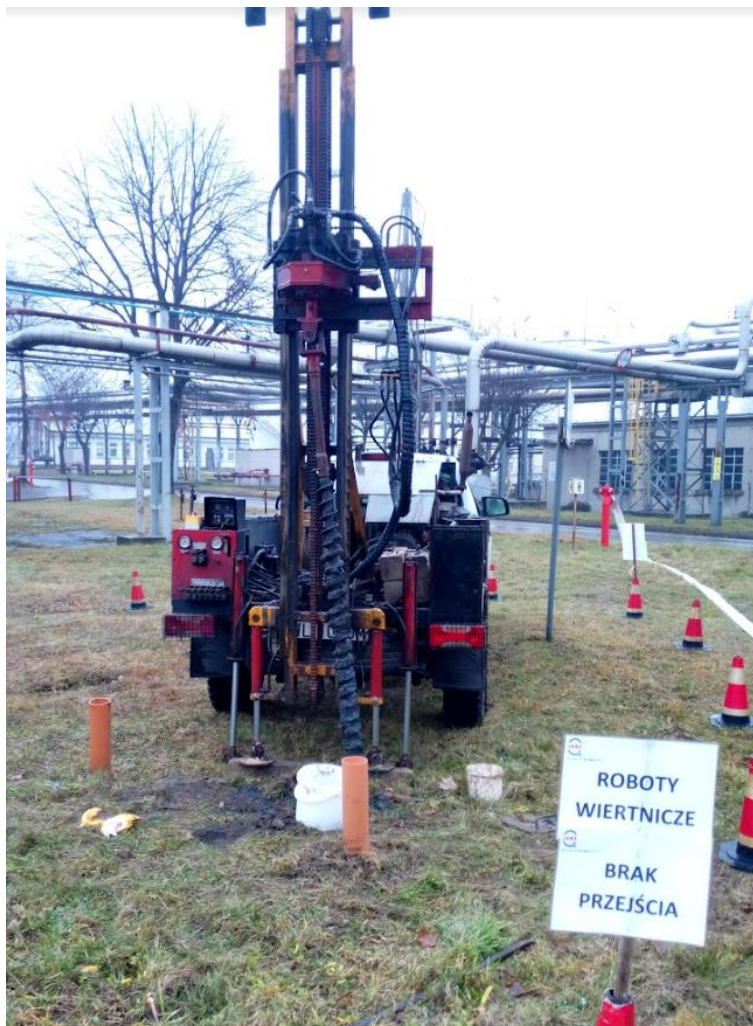
Rysunek 8. Wiercenie otworów badawczych przy pomocy wiertnicy mechanicznej metodą obrotową „na sucho” na terenie poletka badawczego zanieczyszczonego substancjami ropopochodnymi
