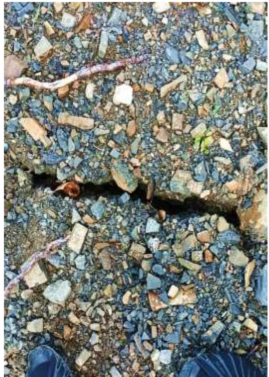
Fot. 59 Szczeliny powstające na skutek sufozji (Fot. A.Ch.)
